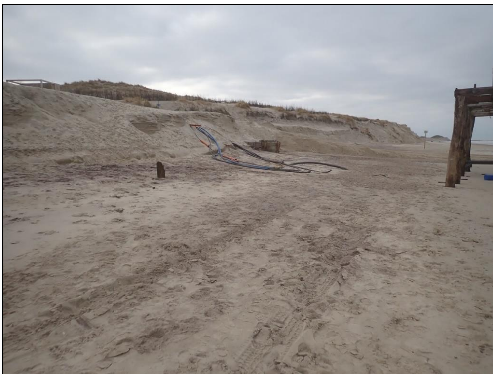
Abbildung 3: Freigespülte Versorgungsleitungen zur Außengastronomie
